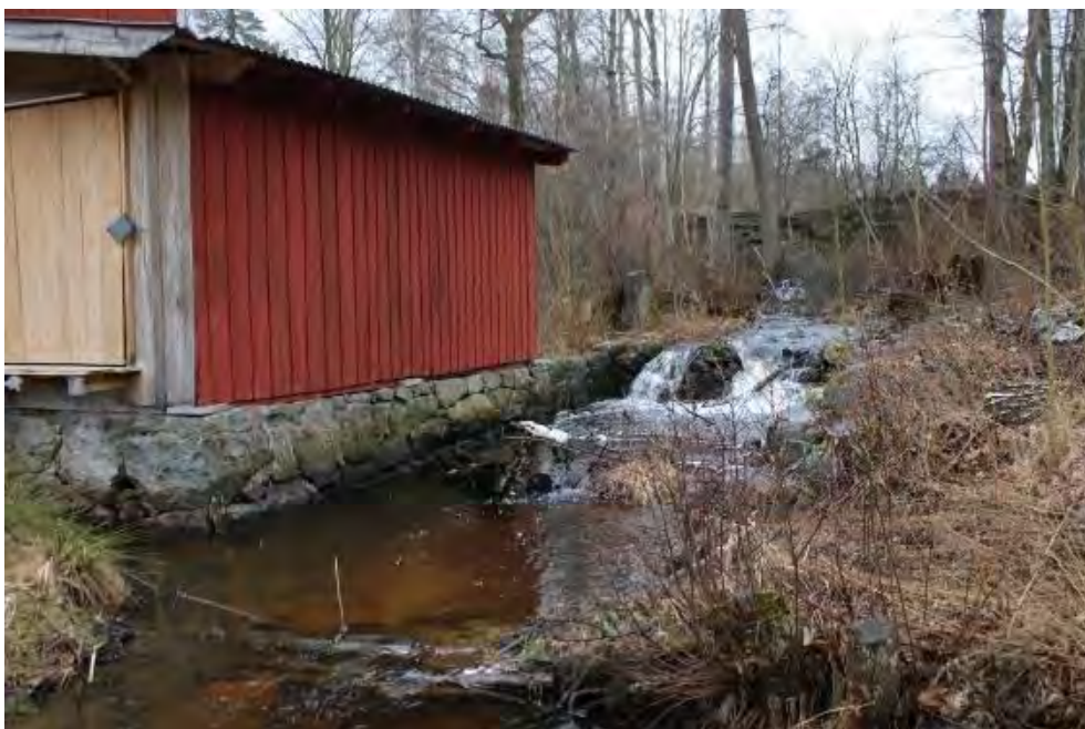
Figur 118. Vid den gamla staketfabriken nedströms Dammen finns ett lägre fall. Kring fastigheten är det stora erosionsproblem där vattnet hotar att underminera fastighetens grund.
