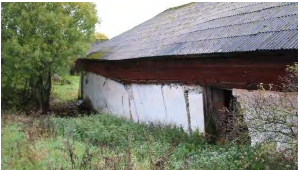
Figur 58. Byggnaden är i dåligt skick och kan med tiden bli ett vandringshinder ifall det inte rustas upp.
