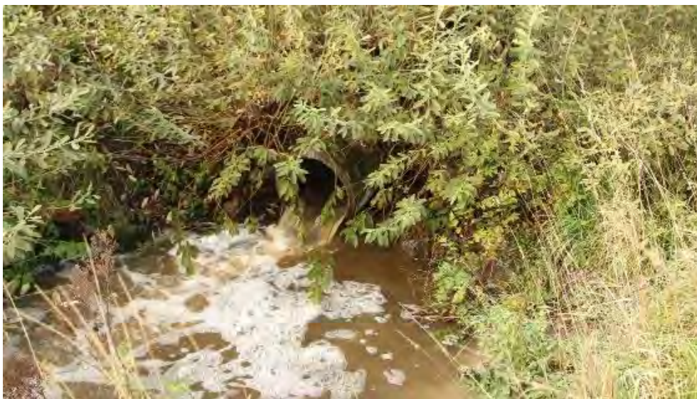
Figur 80. Vägtrumman under väg 224 är för högt placerad. I trumman saknas naturligt substrat och på slutet faller vattnet fritt vilket gör detta till ett definitivt vandringshinder.
