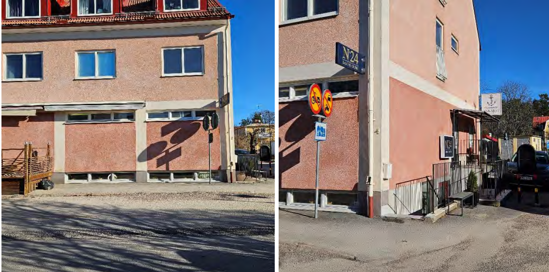
Figur 8 och 10 På bilderna ovan visas fönstren till frisörsalongen i källarlokalen. Till höger visas även trappan ner till frisören.
