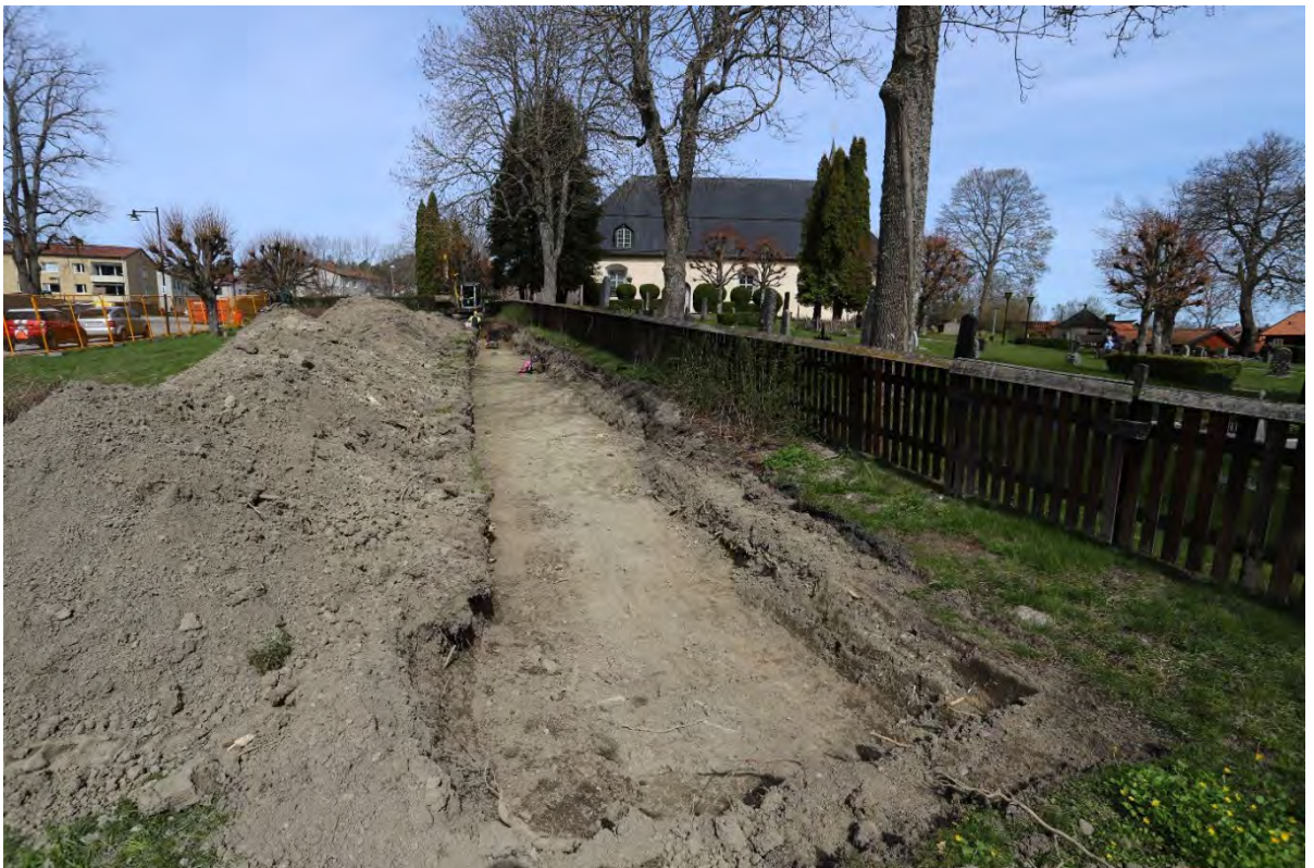
Foto, Schakt 1 fotat från söder. Observera hur schaktet löper strax utanför trästaket till nuvarande kyrkogård.
