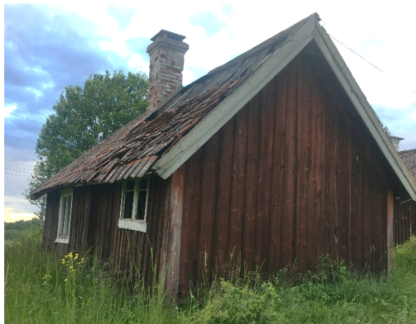
Bild på en av torpstugorna innan renovering.
