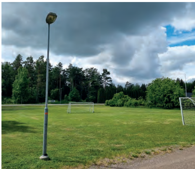
Belysning längs med gång- och cykelvägen och bollplanen.
